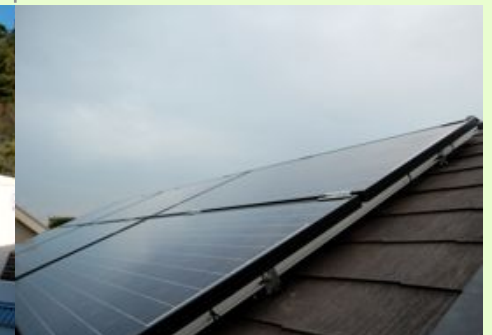
ユーザーと検討し設置された発電所 (東京都大田区)
